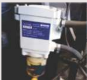
FILTRU SEPARATOR DE APA
